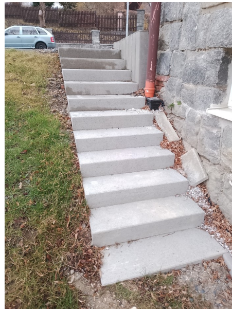
Odvlhčení a schody
